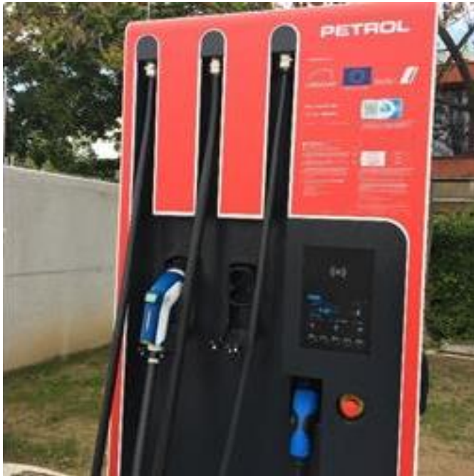
Ladestation der Gesellschaft Petrol. (Quelle: Zavod Rastišče)
